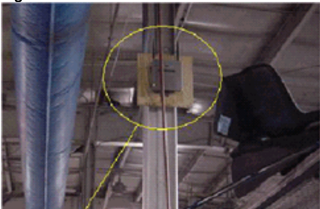
Figura 17: Posicionamento incorreto das antenas perto de um feixe de I
