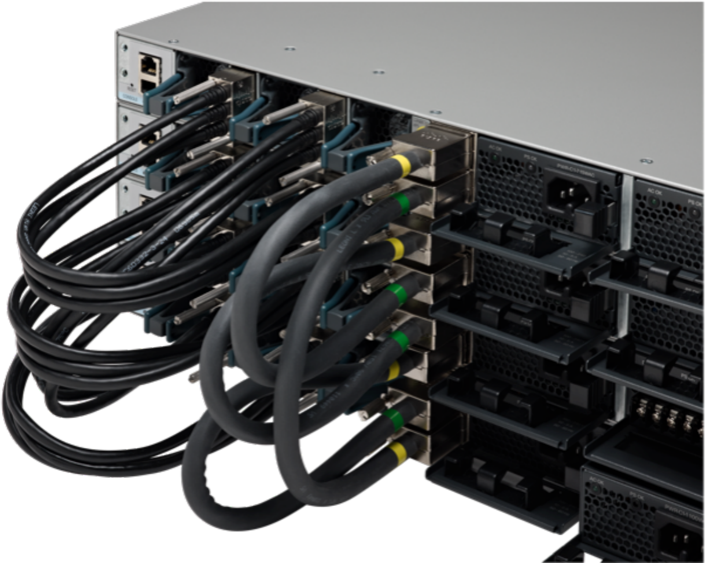
StackPower 및 StackWise 케이블이 올바르게 설치됨
