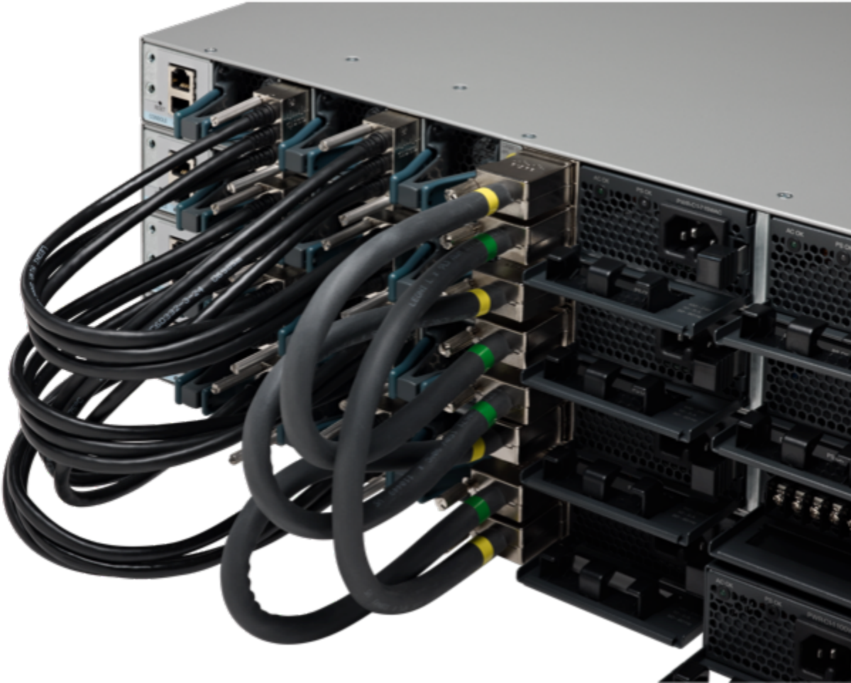
Câbles StackPower et StackWise correctement installés
